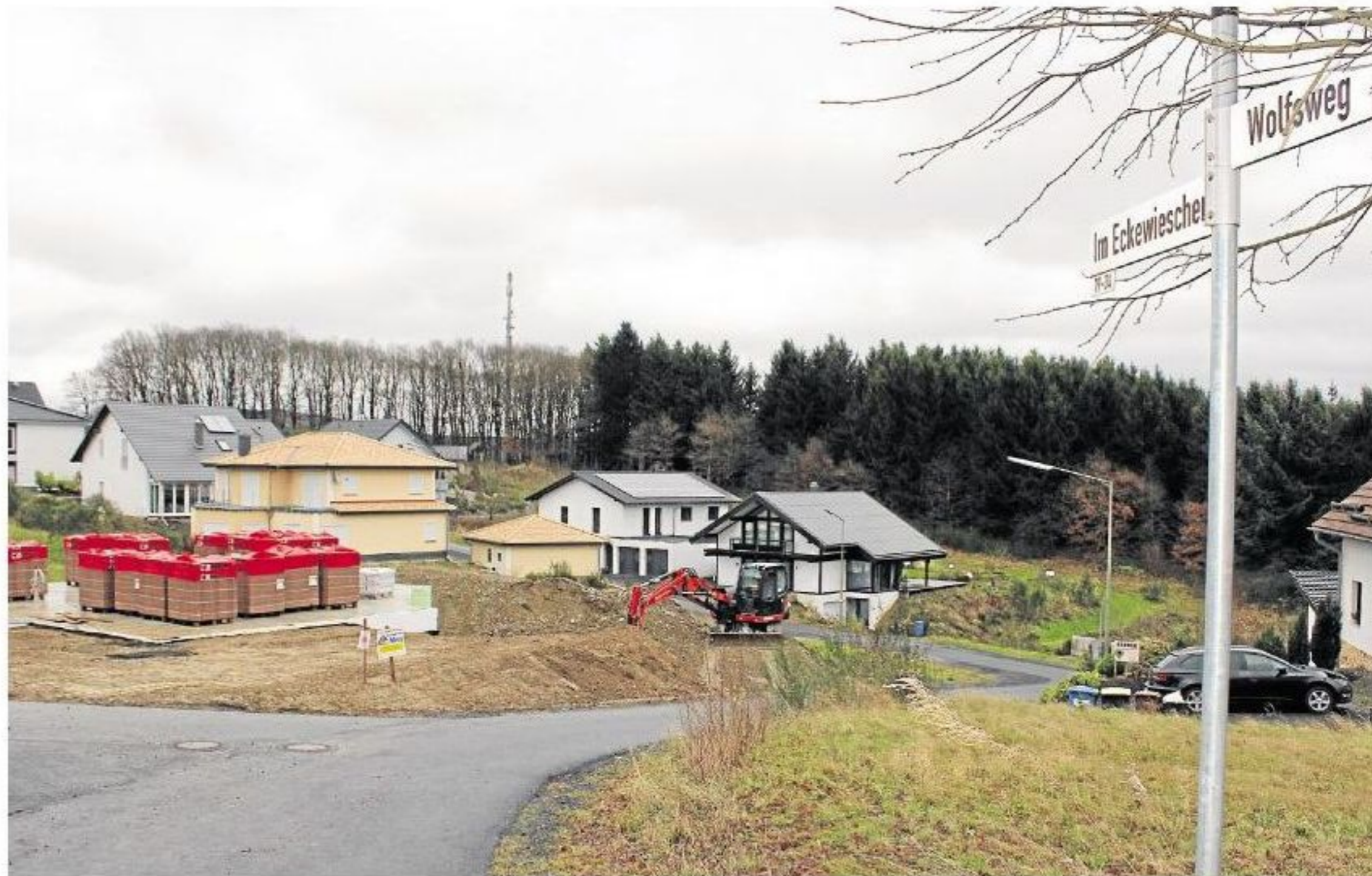
Im Baugebiet Eckewieschen/Steimelsgarten sowie dem angrenzenden Wolfsweg sind die Straßen seit zehn Jahren im Rohzustand. Der Endausbau unter anderem mit Gehwegen und Bordsteinen würde die Anwohner einiges kosten. Etwa die Hälfte will dies erst, wenn alle Bauplätze belegt sind. Foto: Peter Seel
